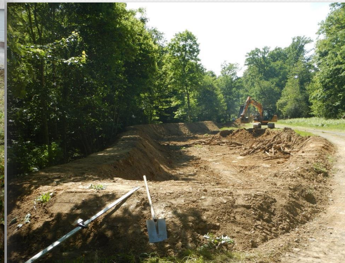
Bassin de stockage des boues
