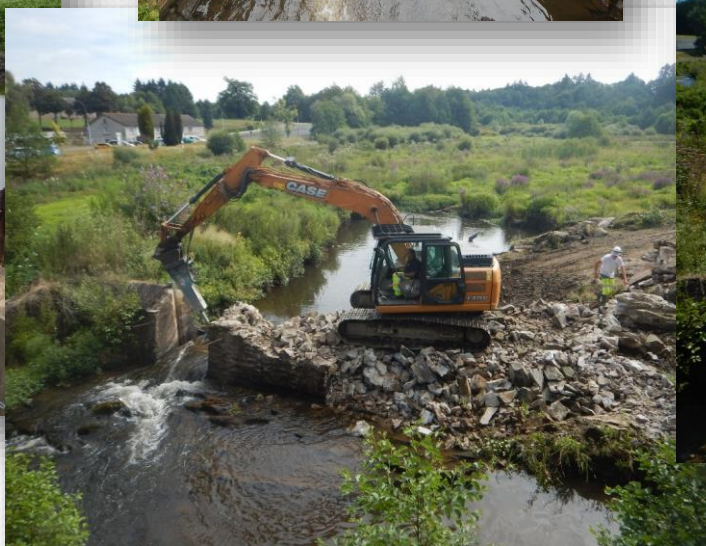
Destruction du barrage (2020)
