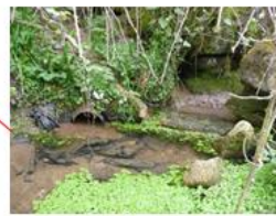
Tuyau bouché entre la source et le bassin réservoir
