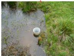
Système de trop plein vers le fossé mitoyen
