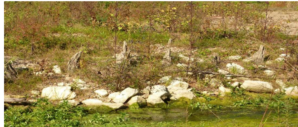
La limite de l'érosion correspond à la zone d'enrochement et d'installation de pieux (ouvrage ancien)
