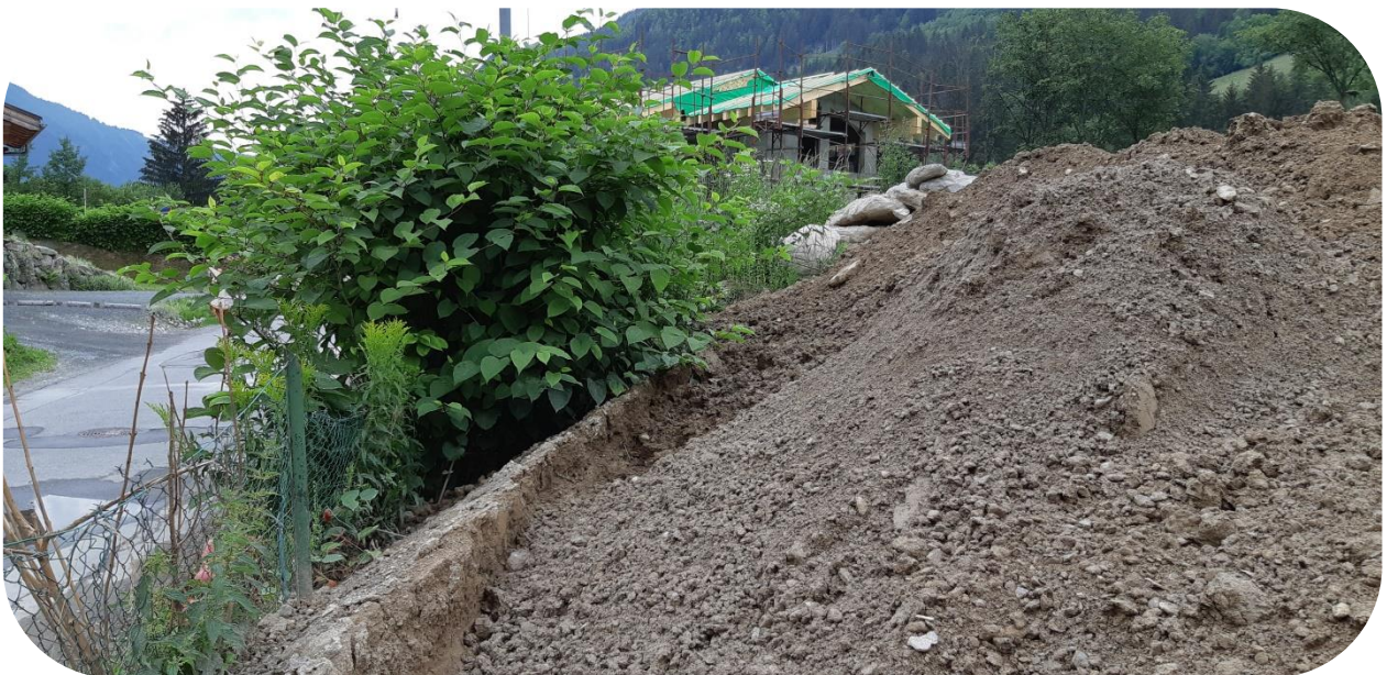
Stockage de matériaux sans précaution sur un massif de renouée - photo ©Aquabio
